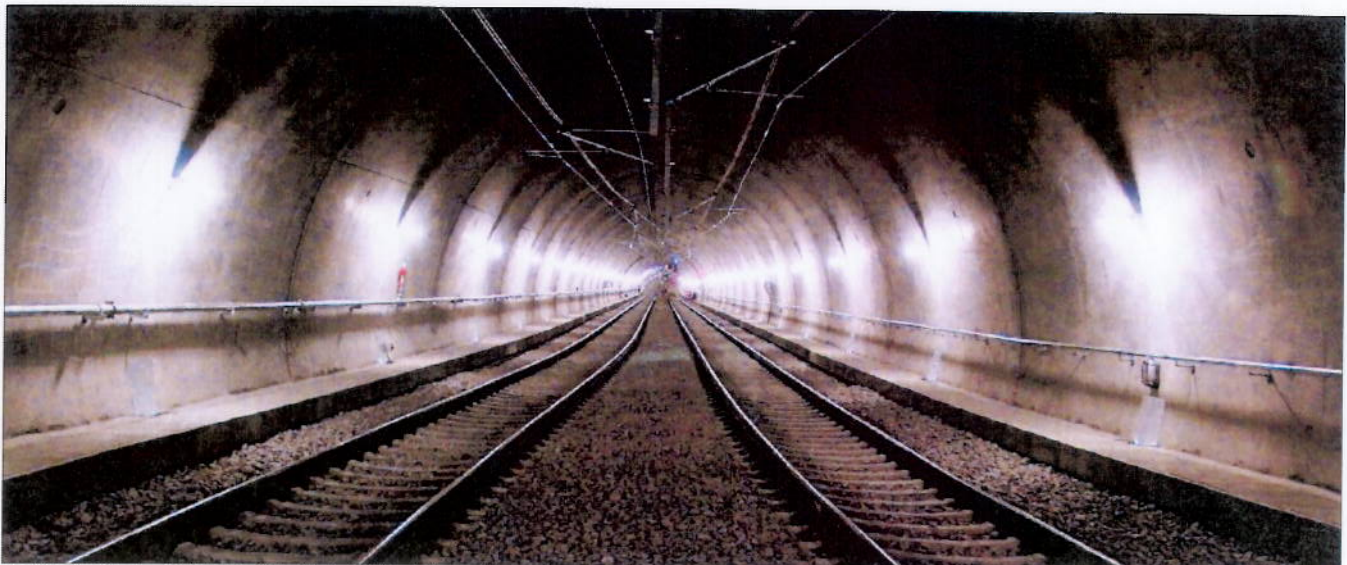
Ohne Technik geht im Tunnel nichts: An der linken Wand verläuft die Läschwasserleitung, an der Decke sind vor kurzen die Fahrleitungen aufgehängt worden. Beleuchtet wird die Röhre von zahlreichen Lampen. Foto: Bernd Zeyer ©
