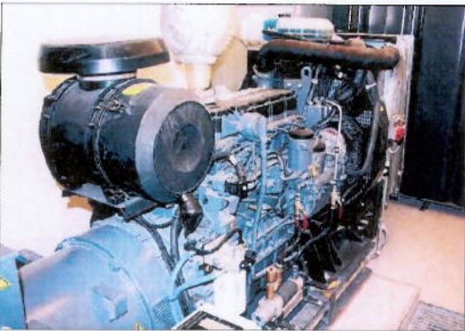
Der Notstromgenerator wiegt zweieinhalb Tonnen und leistet 250 Kilowatt. Er kann den Streckenabschnitt vom Kelterplatz bis zur Strohhäuserstraße mit Energie versorgen.
